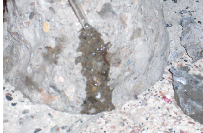
Şekil 6.10. Karbonatlaşma meydana gelmiş beton numune
