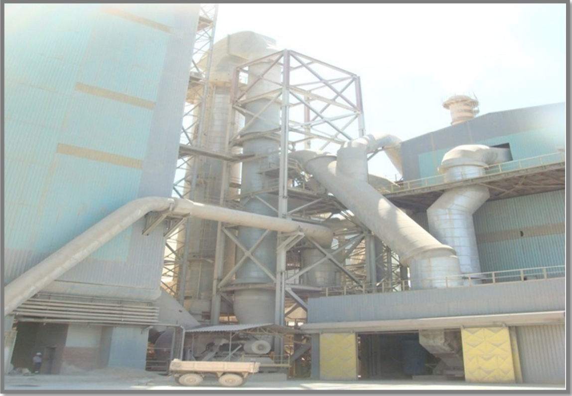
Foto 7: Farin ve Fırın Arasındaki Sıcak Gaz Hatları
