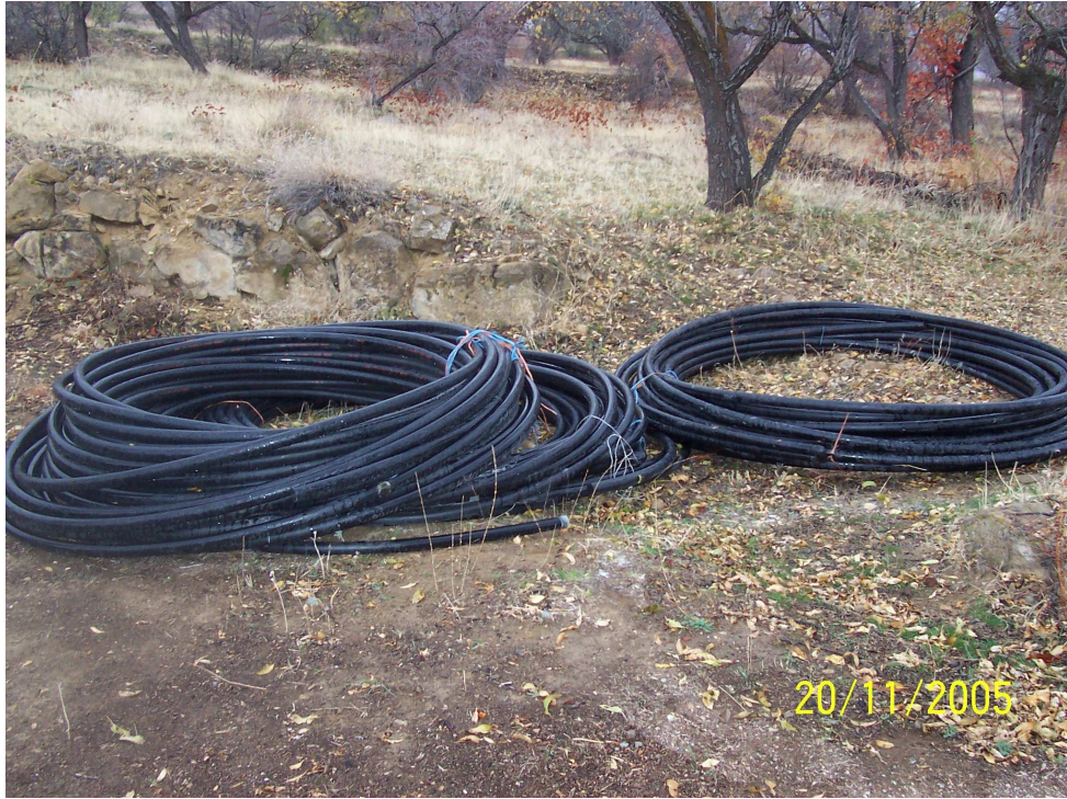
Şekil 3.15. Kangal halinde bulunan boruların görüntüsü
