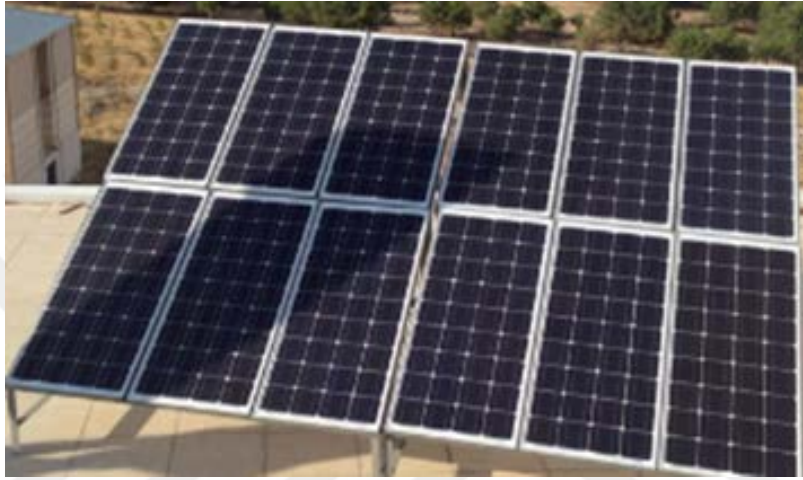
Şekil 1.3. PV dizisi üzerinde oluşan gölgelenmeler
