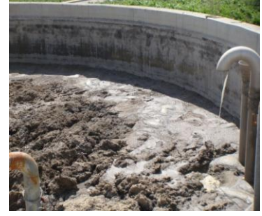
Diyarbakır atıksu arıtma tesisi aşısı alma noktası
