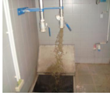
Diyarbakır atıksu arıtma tesisi aşısı alma noktası
