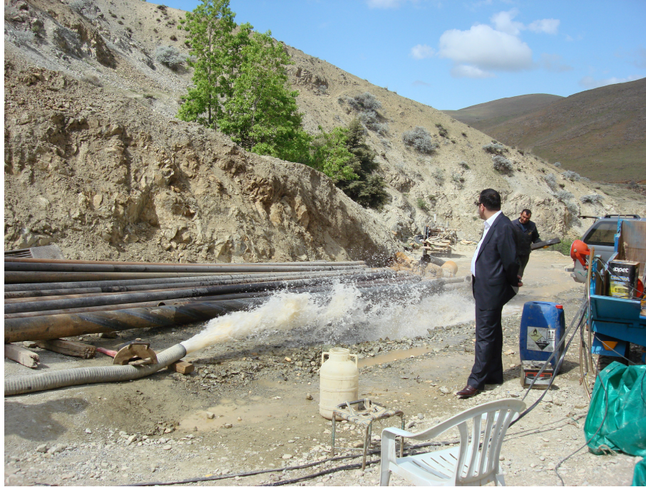
Fotoğraf 9: Singeç Çayı Civarından Çıkarılan Termal Suyun Taşındığı Boru Hattı
