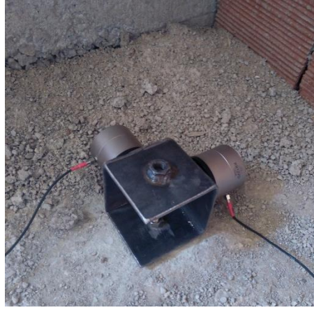
Şekil 5.10. Levha yardımıyla yapıya tutturulan KB12VD tipi ivmeölçerler
