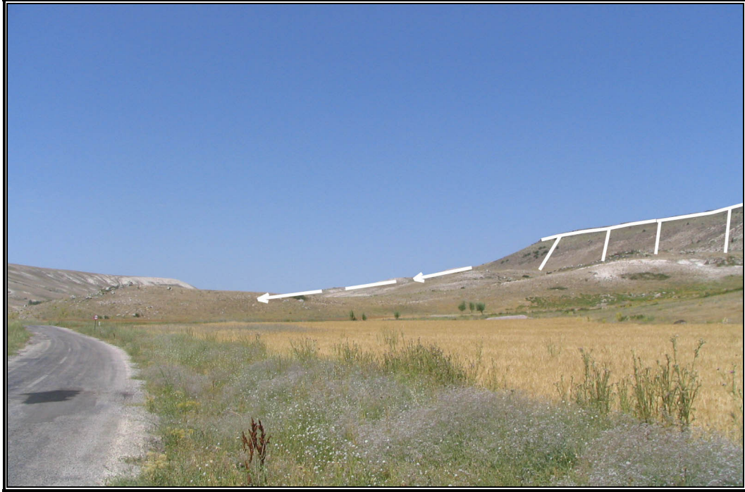
Foto 49: Karaseki Düzü güney yamaçlarında Vahit Mahallesi batısında görülen ve asfalt yolu etkileyen heyelanlar
