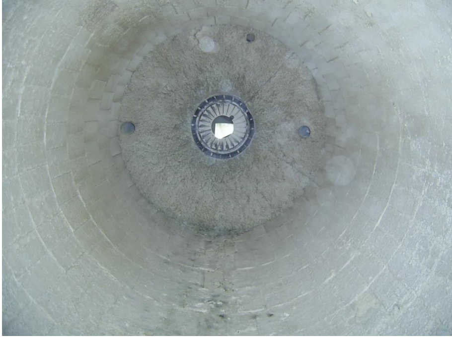
Şekil 2.11. Yanma odasının iç görünüşü
