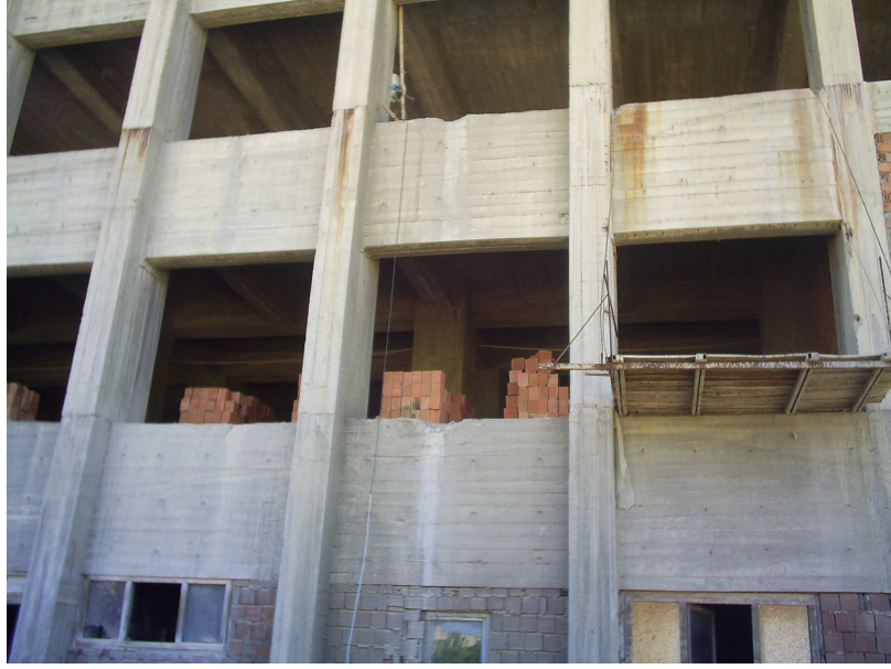
Fotoğraf 4.9. Donatılarda Başlayan Korozyon
