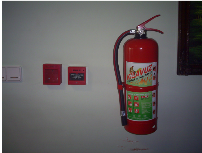
Fotoğraf 4.10. Yangın Alarmları ve Yangın Tüpü
