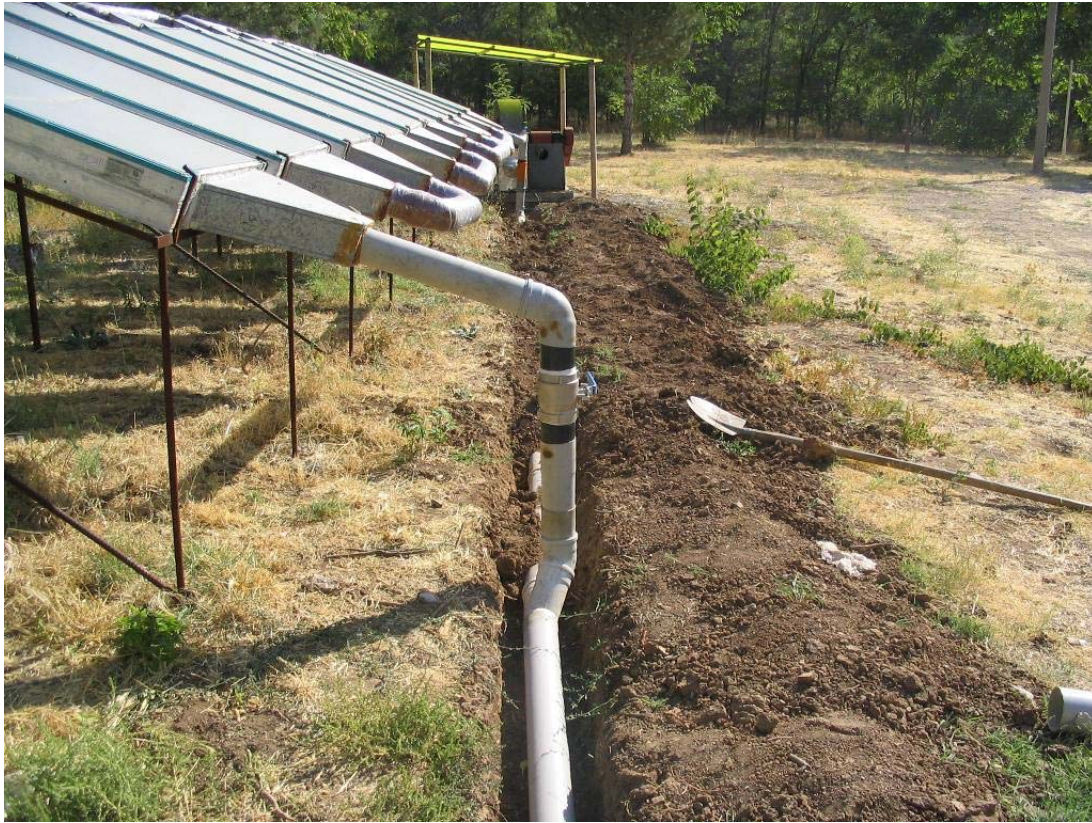
Şekil 3.5 Havalı Güneş Kolektörlerinin Tesisat ve Bağlantıların Görünüşü
