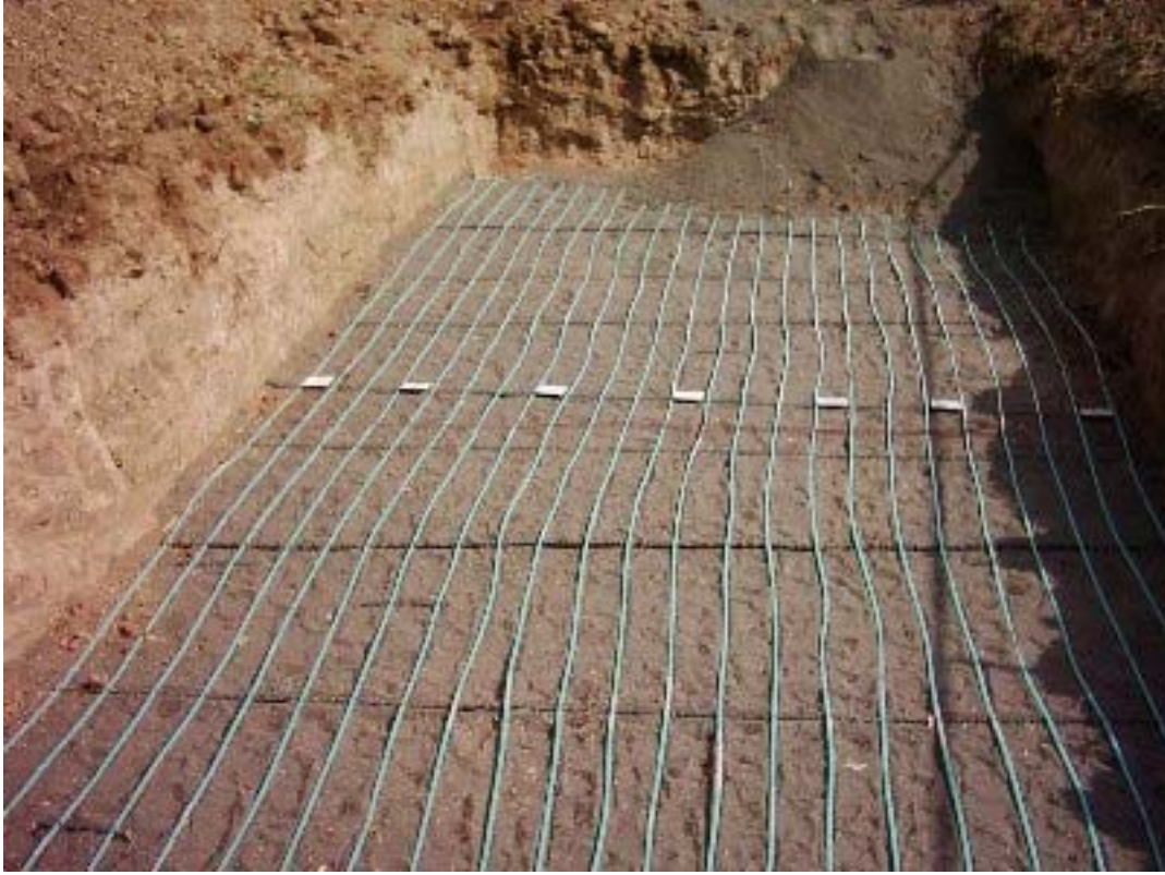
Şekil 3.17 Termoeleman ve Bağlantılarının Görünüşü
