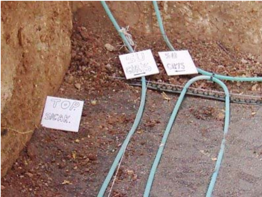
Şekil 3.18 Salamura Su Giriş-Çıkış ve Toprak Sıcaklık Ölçüm Bağlantılarının Görünüşü
