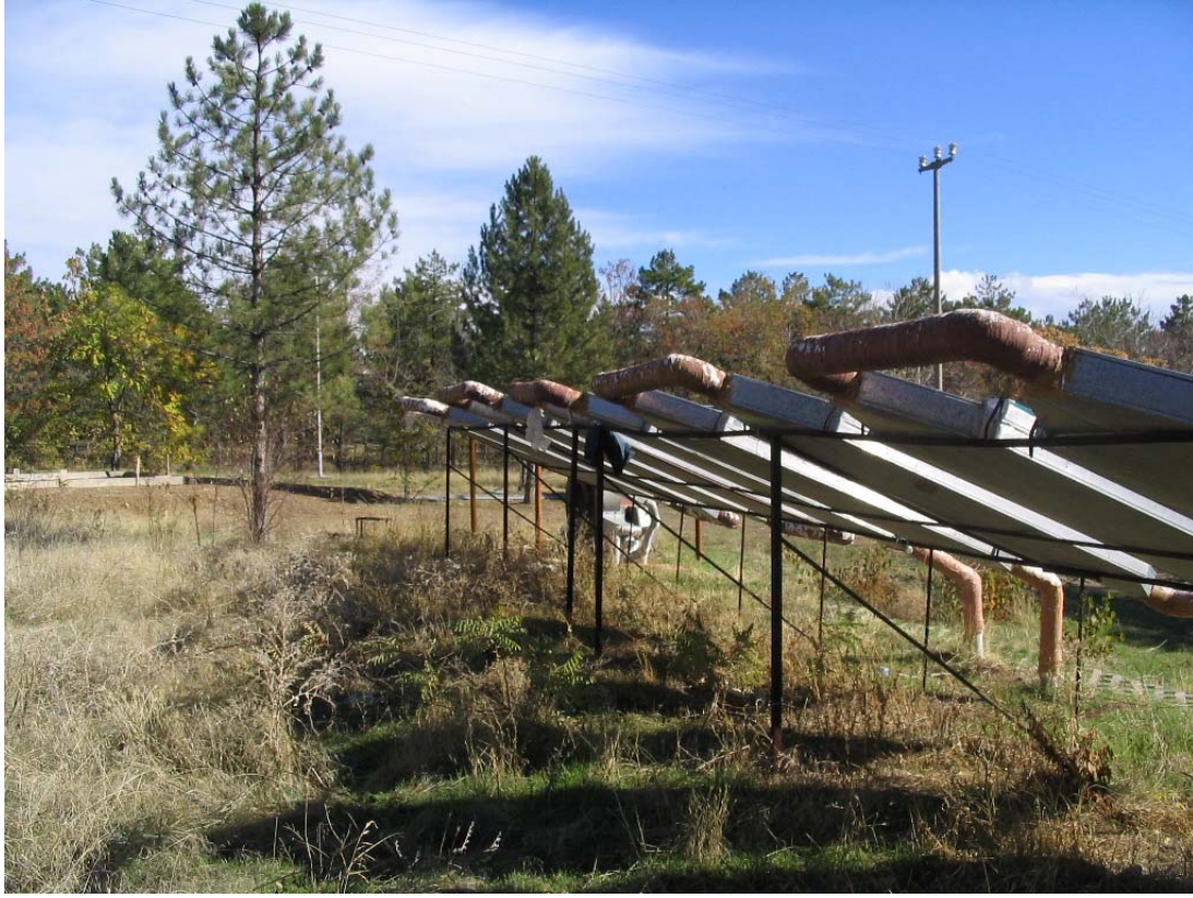
Şekil 3.3 Havalı Güneş Kolektörlerinin Arkadan Görünüşü.
