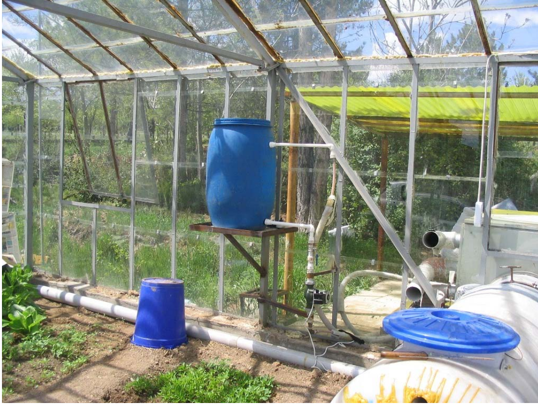
Şekil 3.16 Su Takviye Tankı, Sirkülasyon Pompası ve Bağlantılarının Görünüşü
