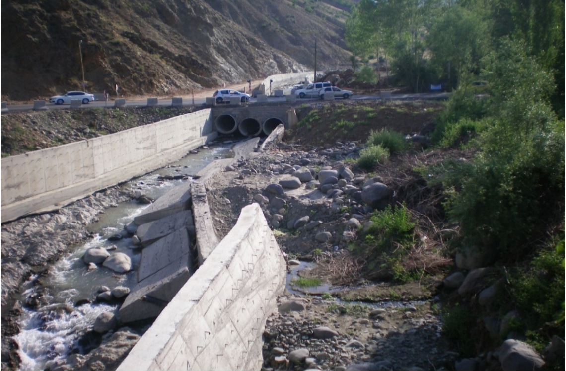
Şekil 1.5. Tahrip olan taşkın kontrol tesisi
