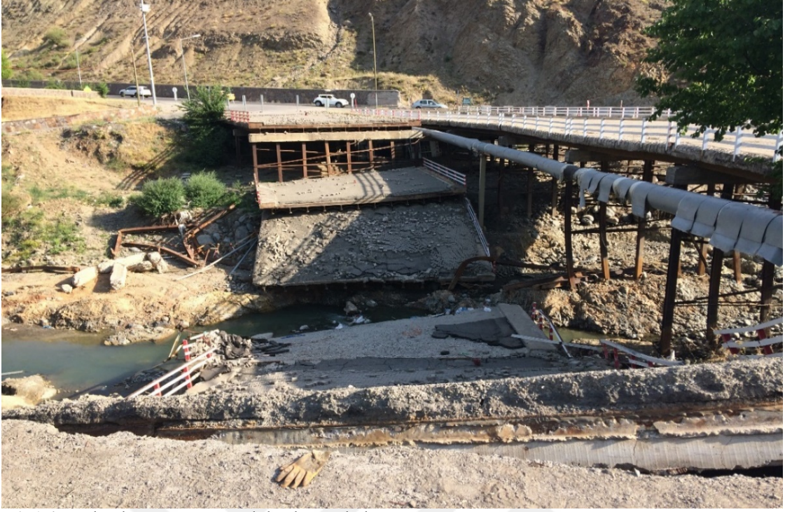
Şekil 1.4. Taşkindan zarar gören yıkılan karayolu köprüsü
