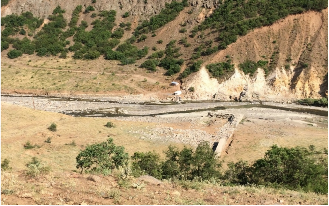
Şekil 1.2. Taşkindan zarar gören orta kısımdaki tersip bendi
