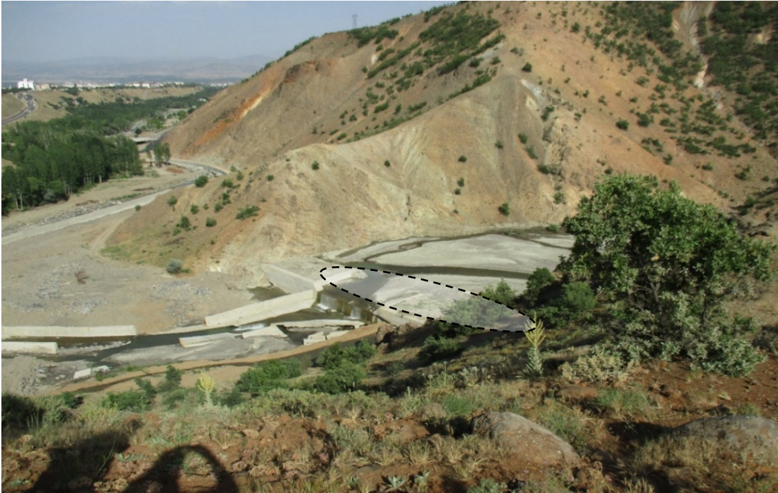
Şekil 1.3. Taşkindan zarar gören mansaptaki tersip bendi
