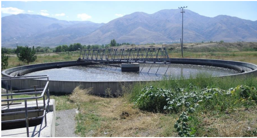
Şekil 6.51. Erzincan Atıksu Arıtma Tesisi Son Çökeltme Havuzu
