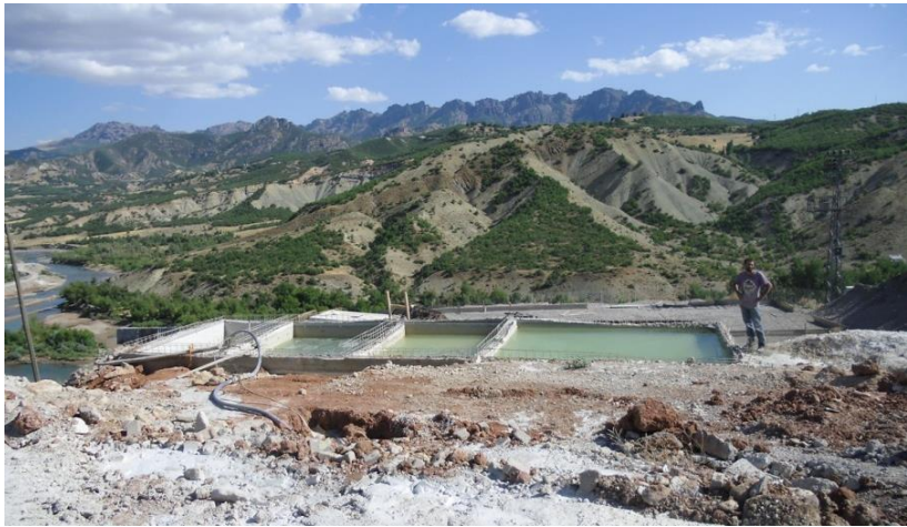
Şekil 6.48. Zel Beton Çöktürme Havuzu
