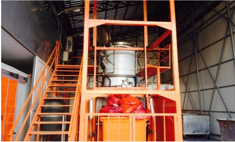
Şekil: 6.16 Elazığ Tıbbi Atık Sterilizasyon Ünitesi
