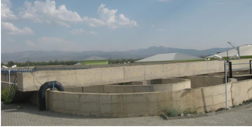
Şekil 6.69. Bingöl Atıksu Arıtma Tesisi
