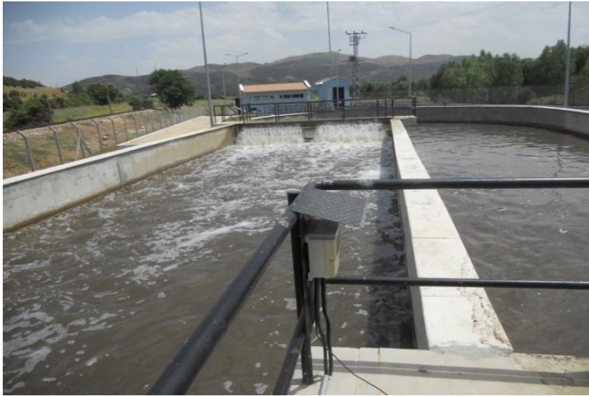
Şekil 6.13. Gezin Beldesi Atıksu Arıtma Tesisi
