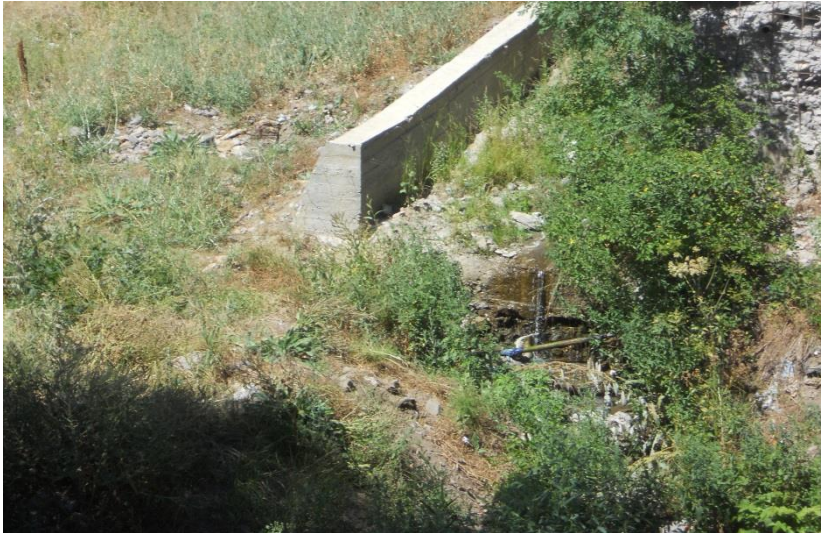
Şekil 6.32. Pülümür İlçesi Evsel Atıksu Deşarj Noktası
