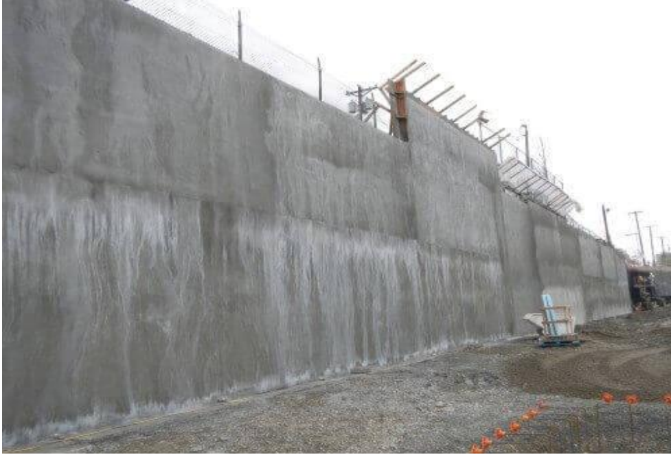
Şekil 2.6. Betonarme perdede meydana gelen çiçeklenme (URL-5,2018).
