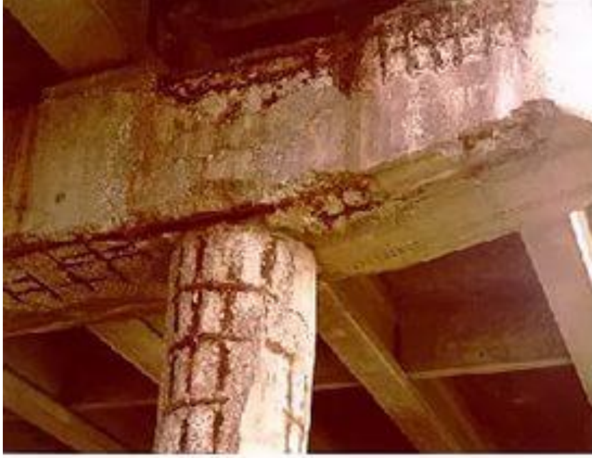
Şekil 2.5. Korozyonun yapı üzerindeki etkisi (URL-4,2016)
