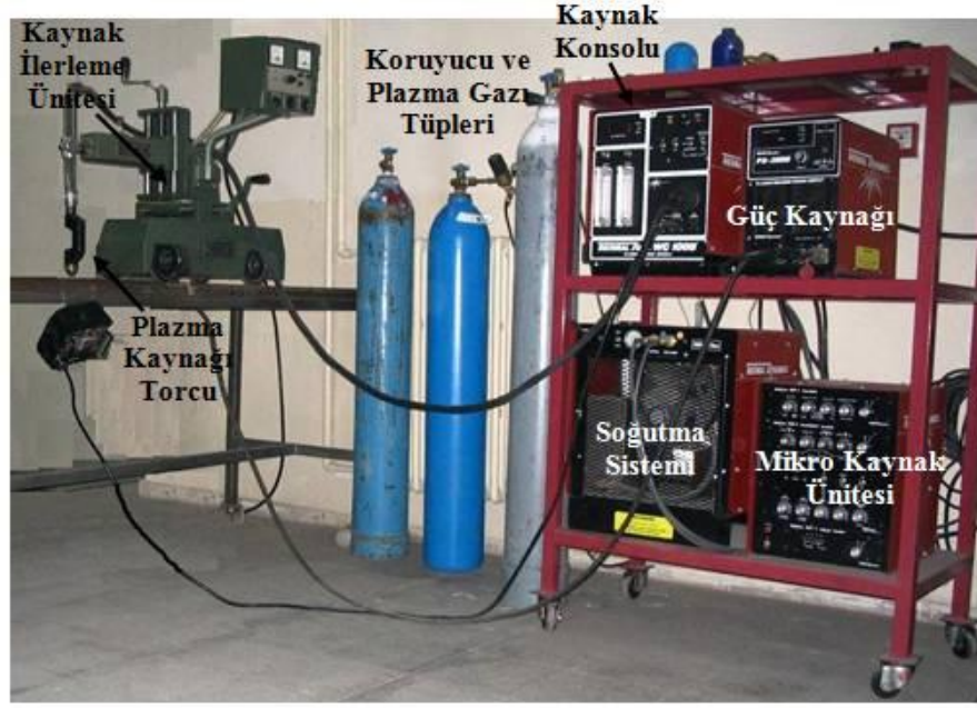
Şekil 4.2. Thermal Dynamic/Arc PTA kaynak makinesi koruyucu gaz tüp bağlantıları ve kontrol paneli
