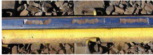
Şekil 2.23. Ray yüzeyinde oluşan çökme arızası [78]
