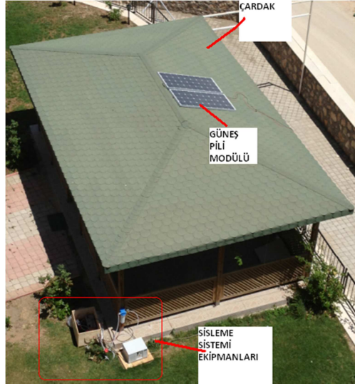
Şekil 4.1. Çardak bölgesi sisleme sistemi
