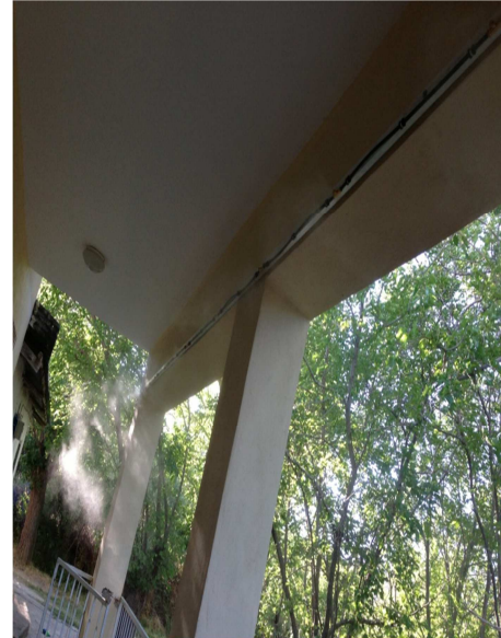
Şekil 4.5. Balkon serinletilmesinin görünümü
