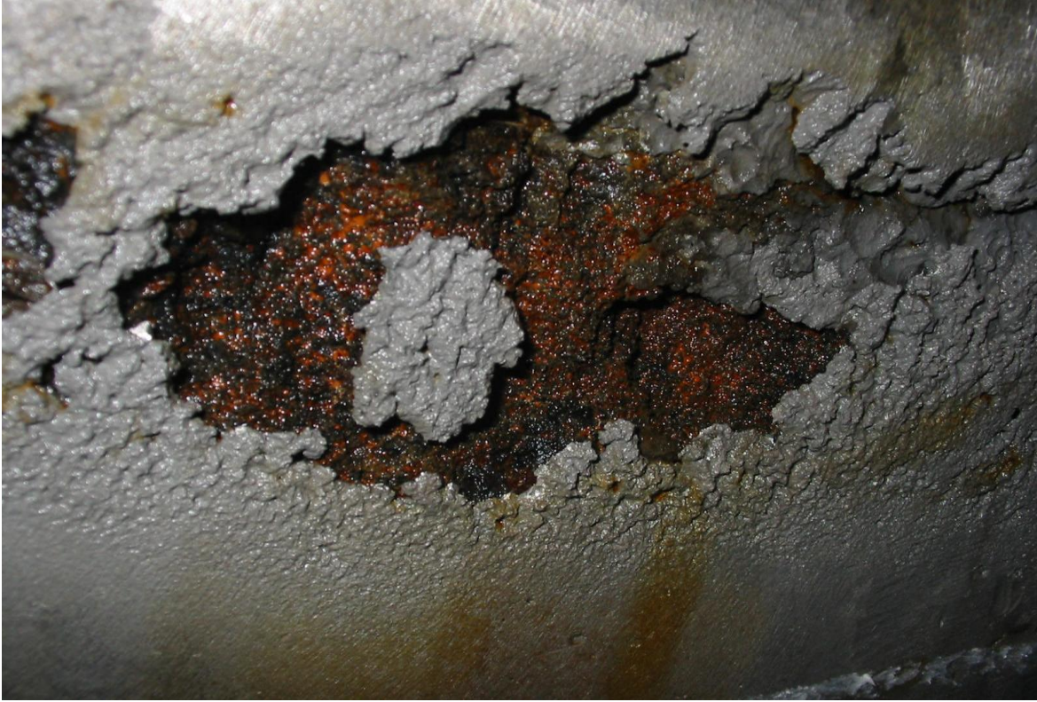
Resim 7. Keban HES’ de hasarlı çark kanadının işaretlenmesi
