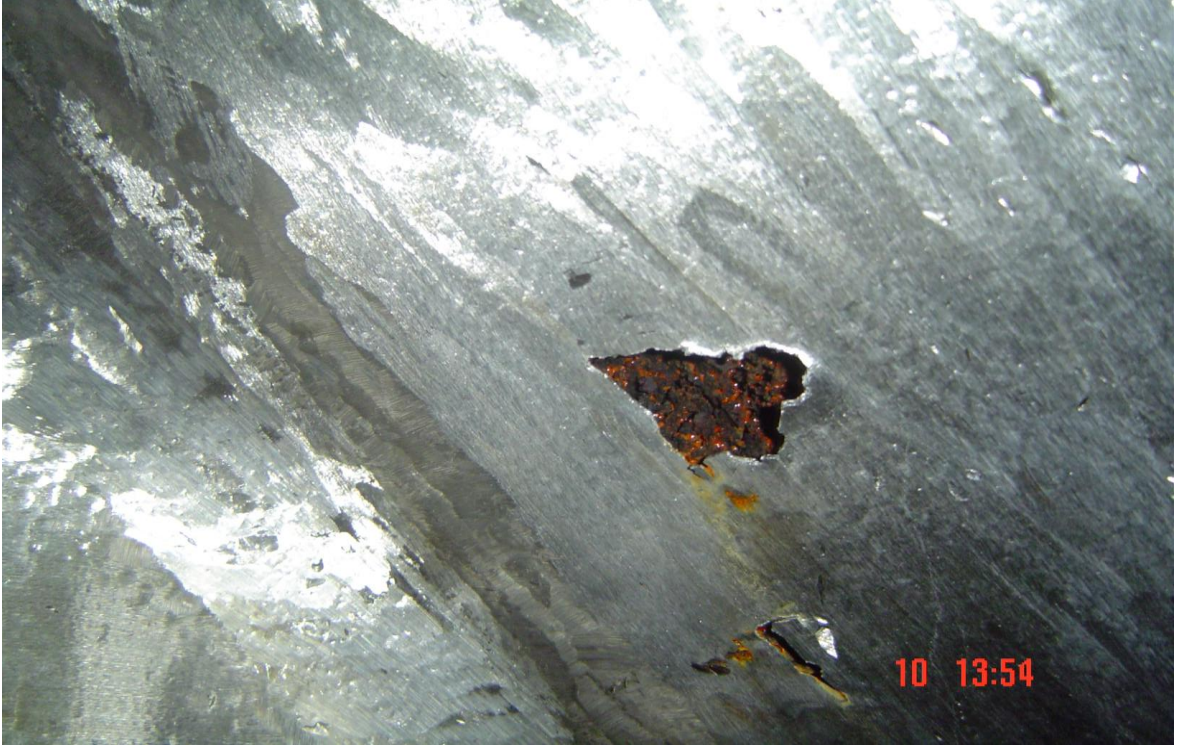
Resim 6. Keban HES Revizyon öncesi çark kanatlarını son durumu
