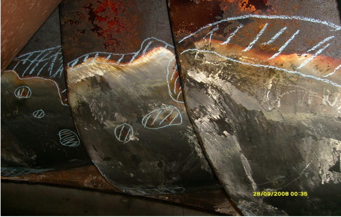
Resim 3. Türbin çark kanatları kavitasyon çalışması [15].
