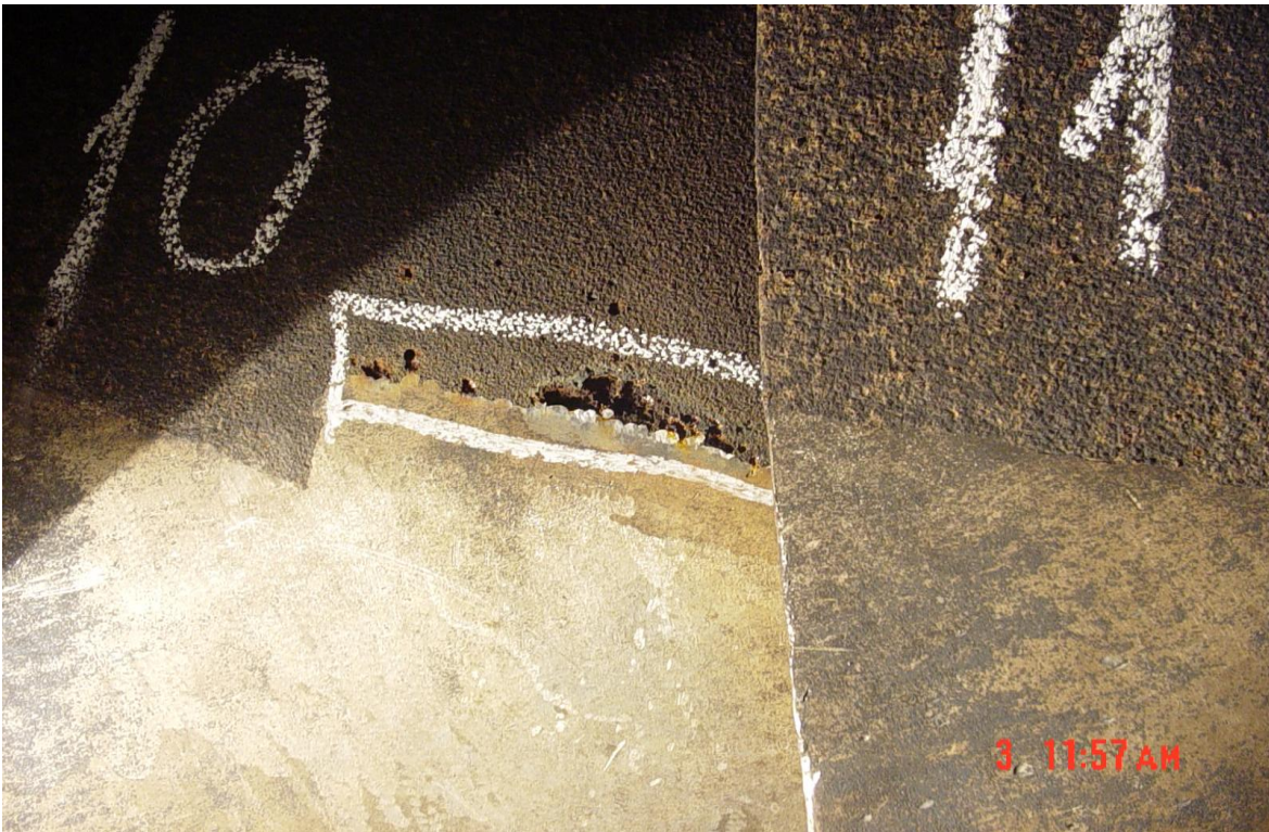
Resim 2. Gökçekaya HES-türbin çarklarının kavitasyona uğramış hali [9] .
