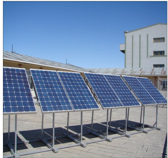
Şekil 5.3. Güneş santrali (2.3 kW)
