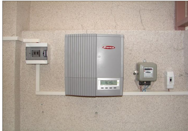
Şekil 5.4. Sistemde kullanılan inverter
