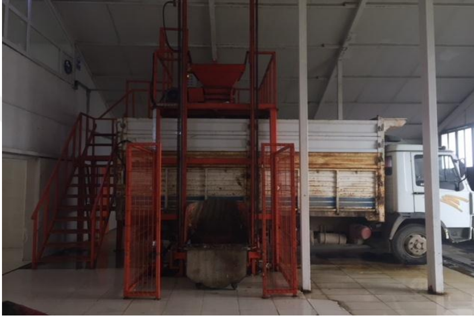
Şekil 3.14. Muş ili tıbbi atık tesisi parçalayıcı ekipman
