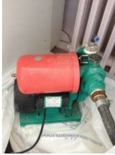
Şekil 3.24. Çalışmamızda kullanılan su pompasının genel görünümü
