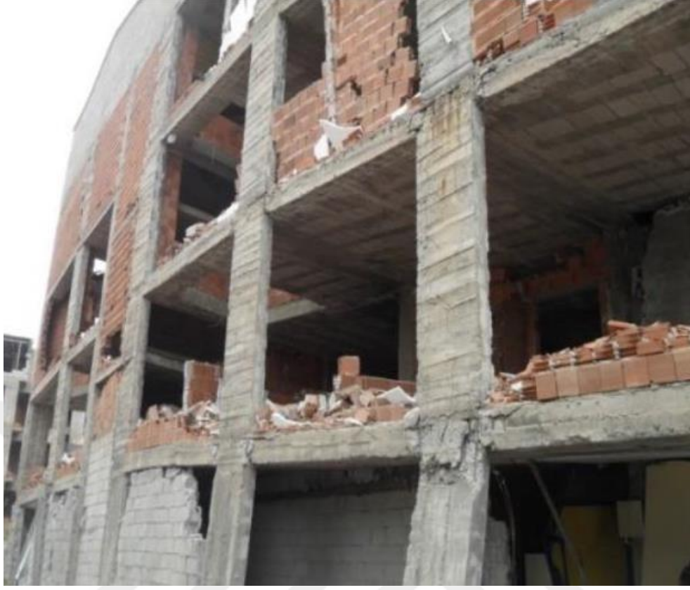
Şekil 3.11 Van Depreminde (2011) hasar almış asmolen döşemeli betonarme bir bina (Ince vd., 2018)
