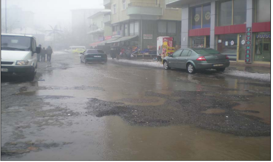
Foto 66.- Yoğun yağış şehir içi ulaşımı ciddi ölçüde aksatmaktadır (Yenişehir Mahallesi)
