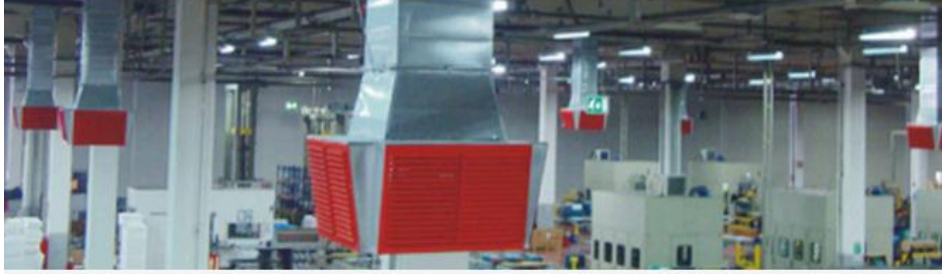
Şekil 3.8. Evaporatif soğutma sistemi ile serinletilen bir fabrikanın görüntüsü.
