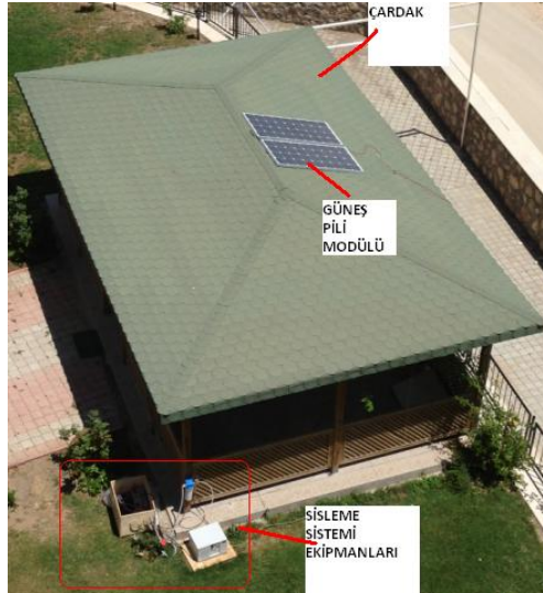
Şekil 4.3. Çardak bölgesi sisleme sistemi.
