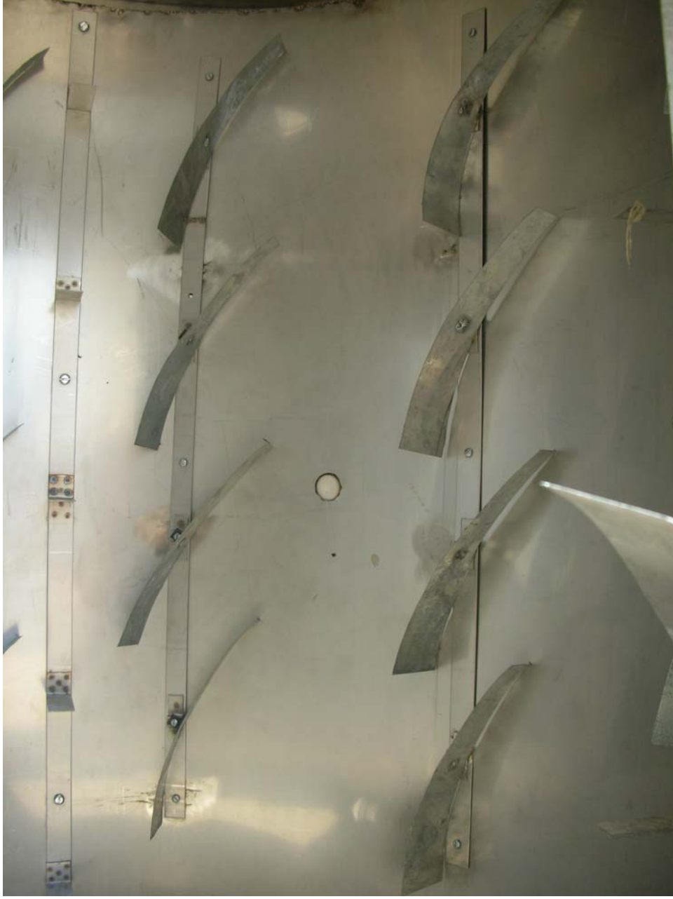
Şekil 7.2. Kurutma odası içerisine yerleştirilen hava yönlendirme elemanları
