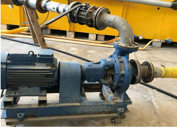
(a) Pompa (11 kW) ve küresel vana
