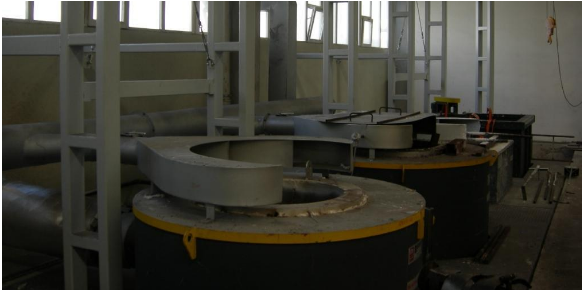
Şekil 2. 26. Isıtma ünitesi genel görünüş
