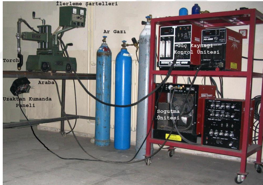
Şekil 8.6. Thermal Dynamic/Ark Plazma Transfer Ark (PTA) kaynak makinesinin tüp bağlantıları ve kontrol panosu
