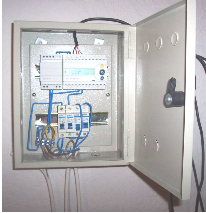
Şekil 3.21 Termostatın elektrik bağlantısının olduğu pano içindeki görünümü
