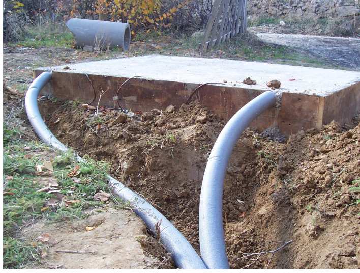
Şekil 3.19 Boruların izolasyonun görünümü
