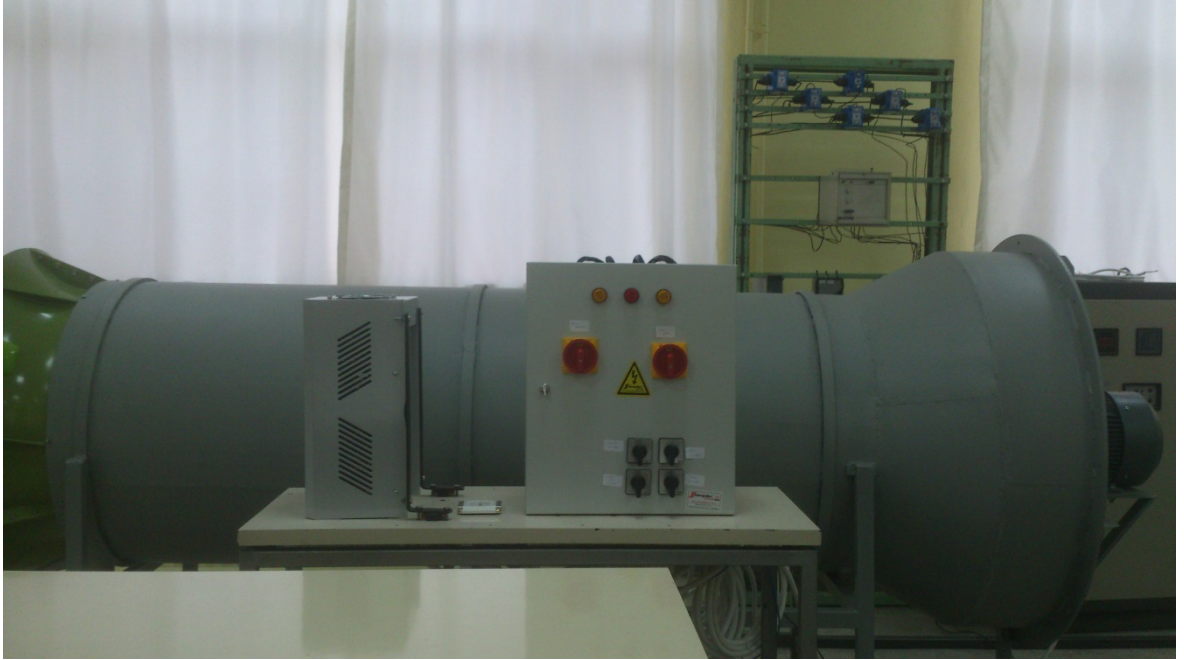
Resim 6-3. Hava kanalı ve elektrik pano görüntüsü
