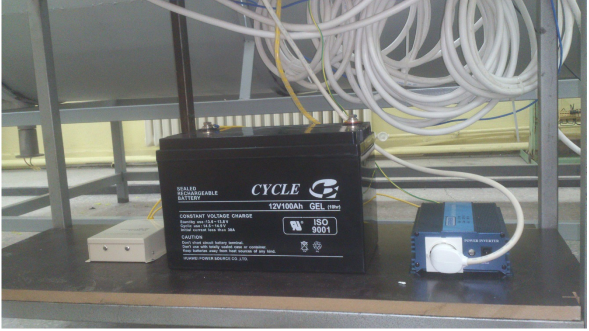
Resim 6-4. Gerilim regülatörü, akü ve inverter görüntüsü
