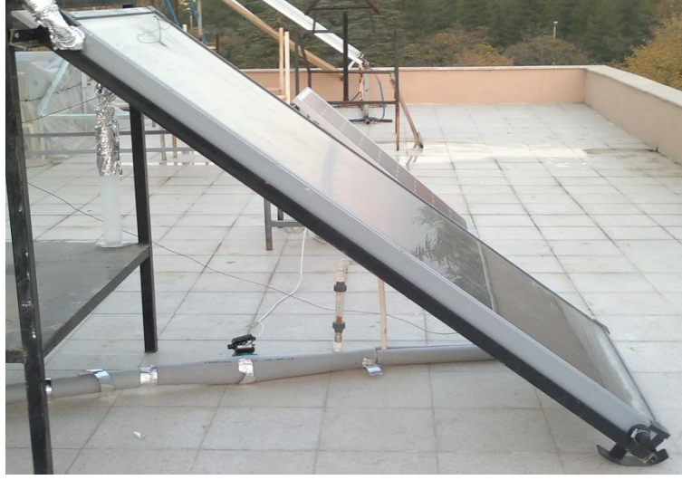
Şekil 2.2. Sıcak su kollektörü
