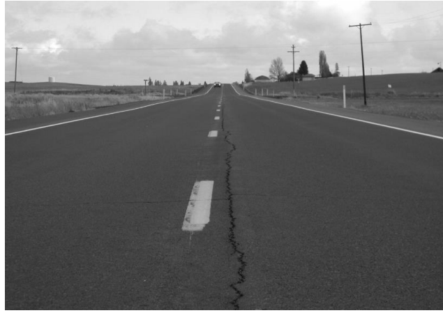
Şekil 4.25. Asfalt betonu kaplama boyuna derz çatlakları
