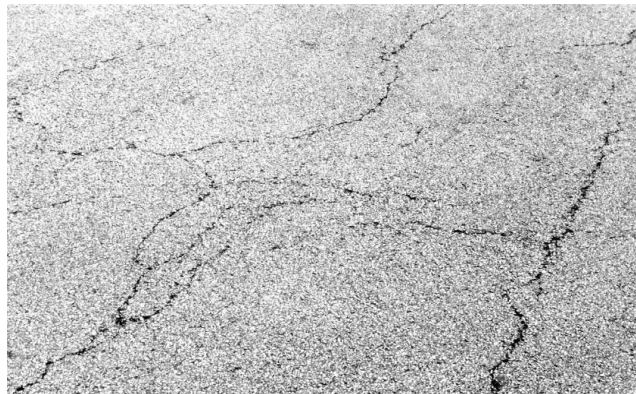
Şekil 4.18. Asfalt betonundaki blok şeklindeki çatlamlar
