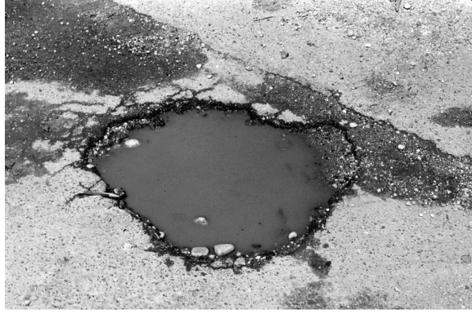
Şekil 4.13. Asfalt betonu kaplama folluk tipi oyuklar
