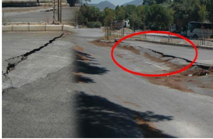
Şekil 4.9. Asfalt betonu kaplamada görülen bölgesel çökmeler
