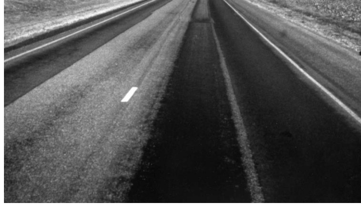
Şekil 4.14. Asfalt betonu kaplaması aşınma tabakası agrega kaybı
