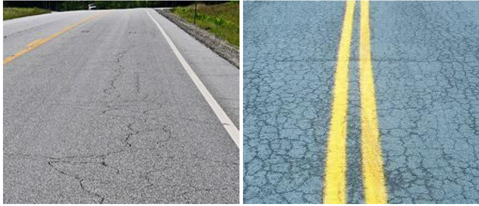
Şekil 4.19. Asfalt betonu yorulma çatlakları kusurları [199].
