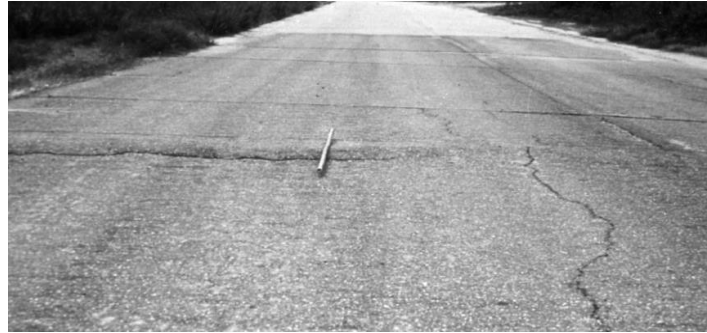
Şekil 4.10. Asfalt betonu kaplamasındaki oturmalar
