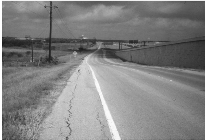
Şekil 4.24. Asfalt betonu kaplama kenar çatlağı
