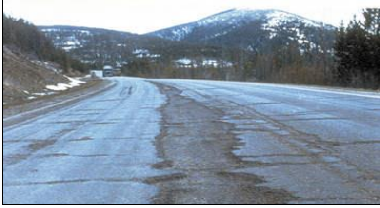
Şekil 4.12. Asfalt betonu üniform olmayan yüzey bozuklukları [199].
