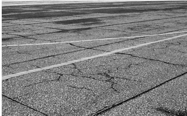
Şekil 4.21. Asfalt betonu kaplama yansıma çatlağı
