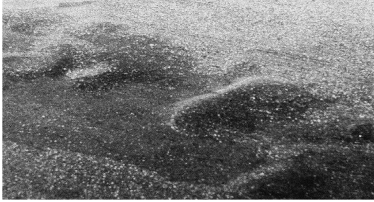
Şekil 4.11. Asfalt betonu kaplamasında görülen kabarma ve yığılmalar
