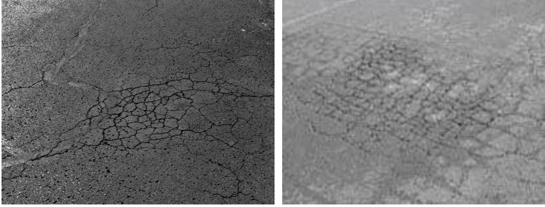
Şekil 4.23. Asfalt betonu kaplamalardaki timsah sırtı çatlak bozulmaları [202].
