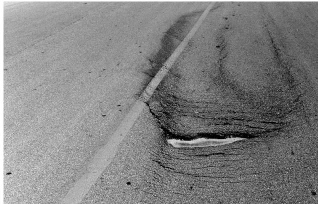
Şekil 4.27. Asfalt betonu kaplamalardaki kayma çatlağı
