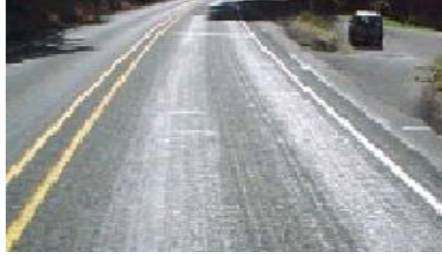
Şekil 4.7. Asfalt betonu kaplama lastik deseni oluşumları
