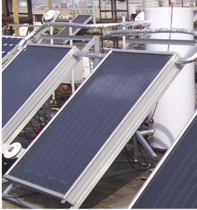
Şekil 1.10. PV/T kolektörünün genel görünümü [33]
