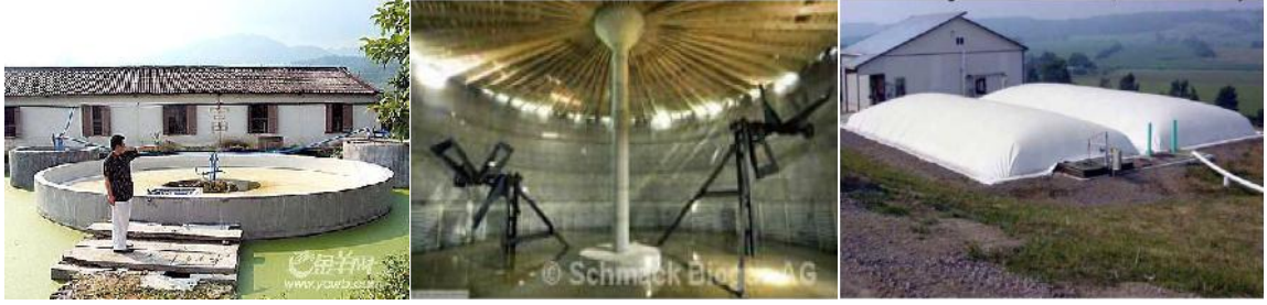
Şekil 1.38. Tam karışımli anaerobik arıtma tesislerinden görüntüler (Pehlivan, 2009)
