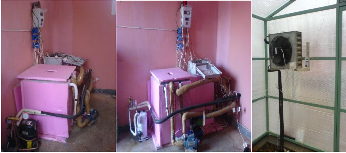
Şekil 2.16. İmal edilen ısı pompası sisteminden görüntüler
