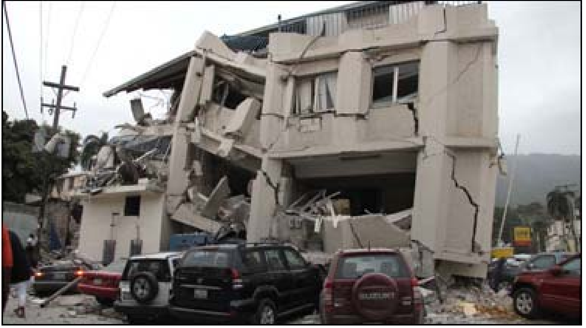
Şekil 2.3 Haiti depreminde hasar görmüş bir yapı
