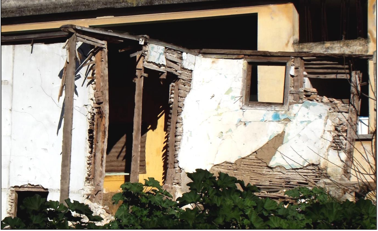
Foto 18: Ceyhan'ın Eski Mahallelerinden Konakoğlu Mahallesi'nde Yıkılan Dolma Evin Duvarı
