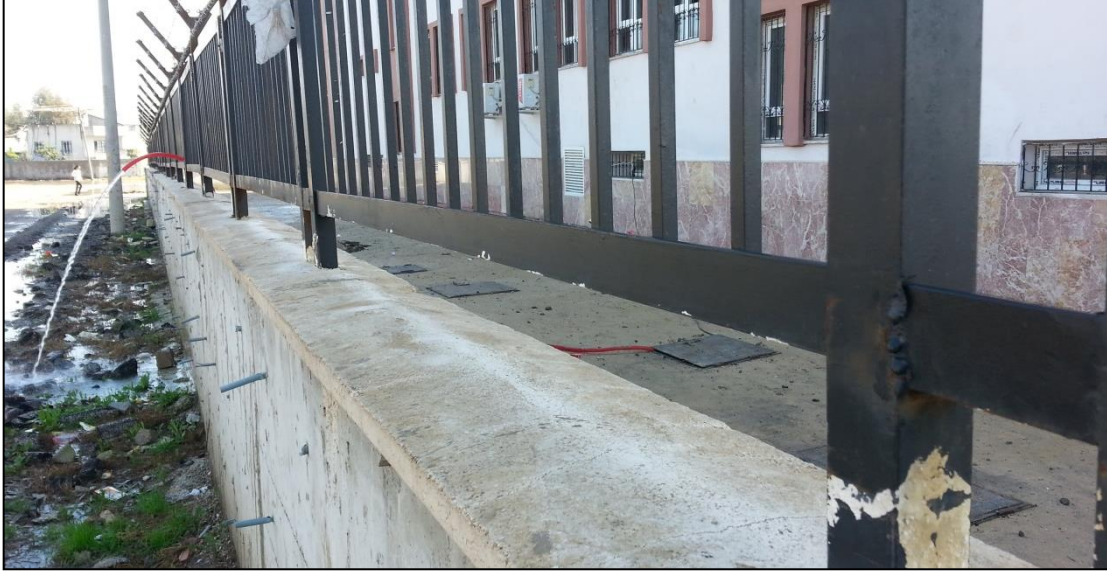
Foto 123 : Belediye Evleri Mahallesi Kaymakam Grbz Karakuş Ortaokulunda Mahzene Dolan Yağmur Suyu Sorunu
