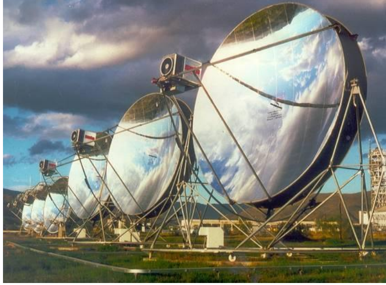
Resim 2.11. Parabolik çanak güneş ısı elektrik santrali (İspanya)
