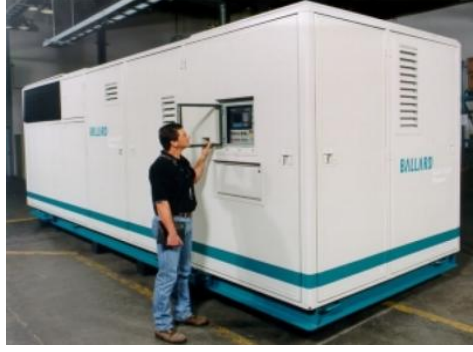
Şekil 2.5. Yakıt pili kullanan bir dağıtık güç santrali
