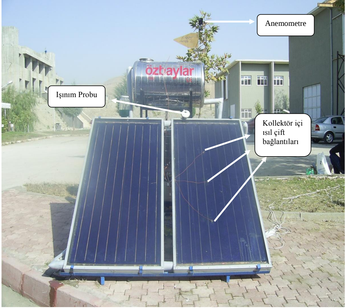
Şekil 2.11. Güneş enerjili su ısıtma sisteminin önden görünüşü.
