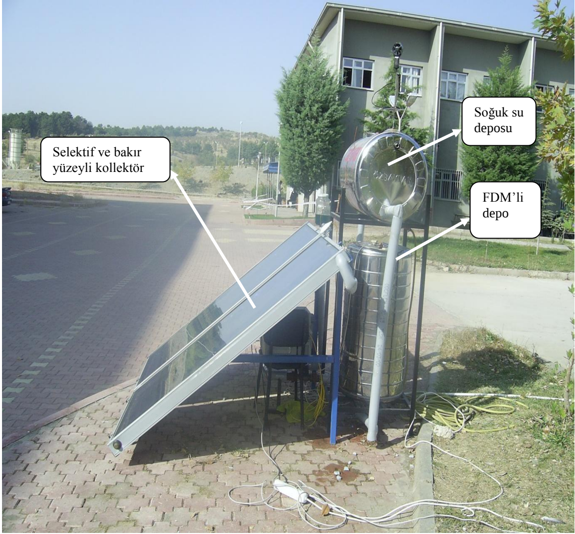
Şekil 2.7. Güneş enerjisi sistemi ve ekipmanları.
