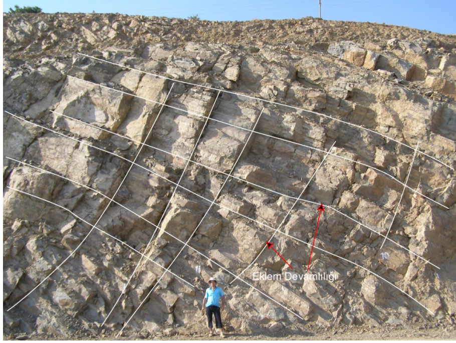
Şekil 4.5. İnceleme alanındaki silttaşlarında gözlenen eklem devamlılıkları.
