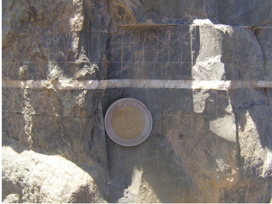
Şekil 4.8. Silttaşı eklemlerinde gözlenen kalsit dolgu.
